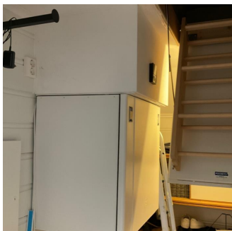
Aggregat for ventilasjonsanlegg er installert ved teknisk rom i 2.etg.
