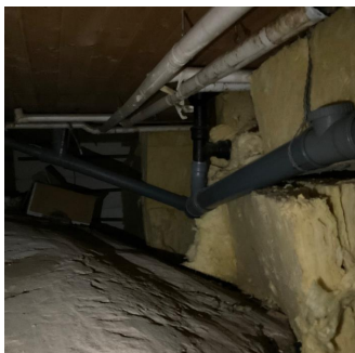
Rørføring i krypekjeller med stakepunkt på avløpsrør
