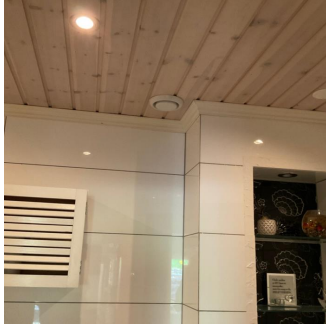
Avtrekkventil i himling på badrom
