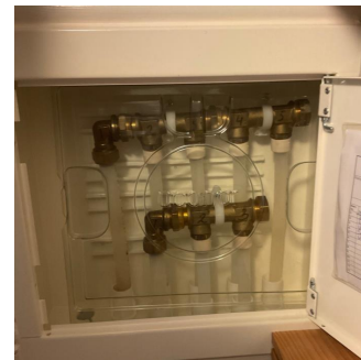
Fordelerskap i vegg teknisk rom / badetrom 2. etg.
