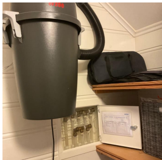
Sentralstøvsuger _ enhet på teknisk rom
