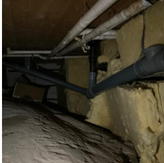
Avløpsrør i krypekjeller føres til hovedavløp _ ukjent alder på nedgravde rør
