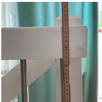
Høyde av rekkverk er 92 cm ( krav er 90 cm )
