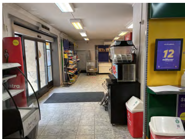
Eldre energikrevende lysarmaturer. Bedre lys og mye energi spart ved utskifting til led-armaturer.
