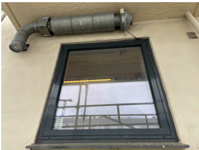
Utvendig avkast. Filterboks før lydfelle. Vanskelig tilkomst.
