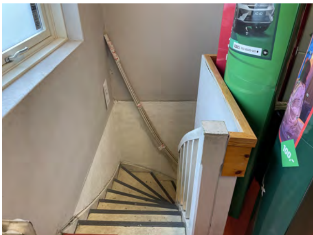
Trapp til kjeller. Slitte overflater i trapp.
