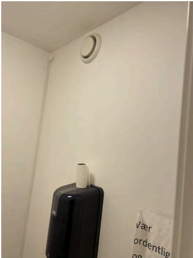
Ventil fra toalett i kjeller 1. Her går ventil kun ut i tilstøtende rom.
