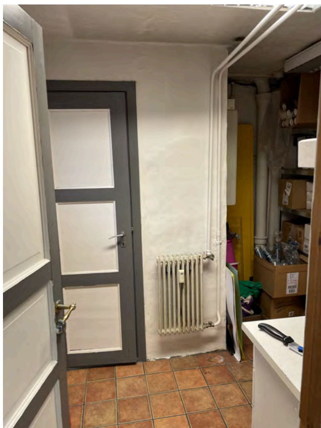
Radiator i rom kjeller 2
