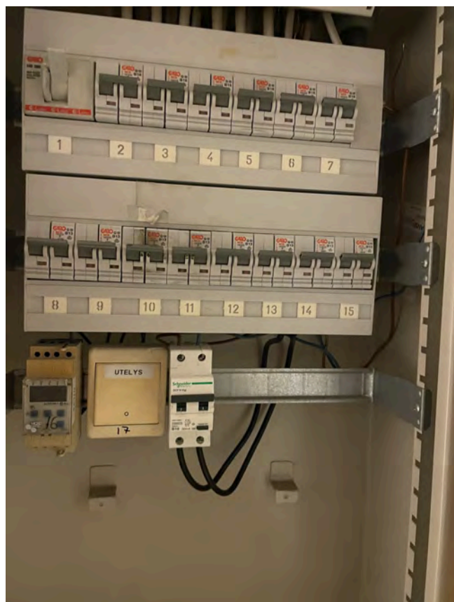
Sikringsskap med automatsikringer. Kan med fordel oppgraderes til jordfeilautomater.
