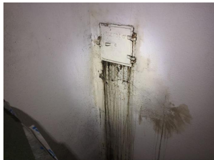
Rennemerker under sotluke.
