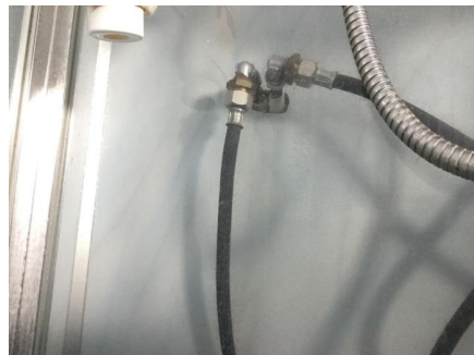
Utettheter rundt rørføring i våtsone.
