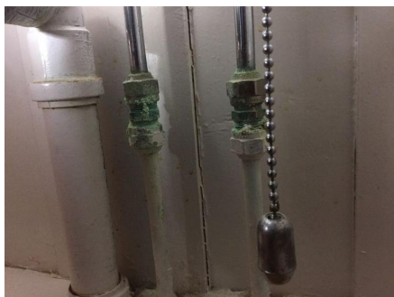
Irr på rør registrert.
