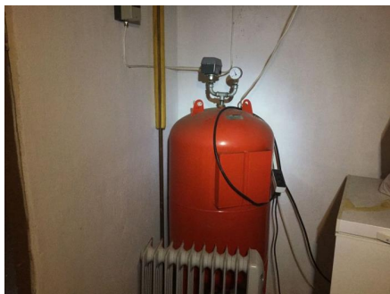
Trykktank plassert i kjeller.
