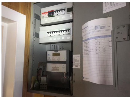
Sikringsskap med undermåler plassert i gang 2. etasje.
