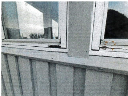
Råteskadde vinduer i tilbygg
