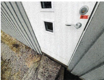
Dørblad har skade utvendig til garasje.
