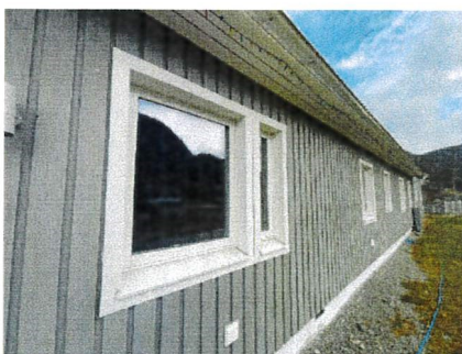
Ingen vannbord over vinduer
