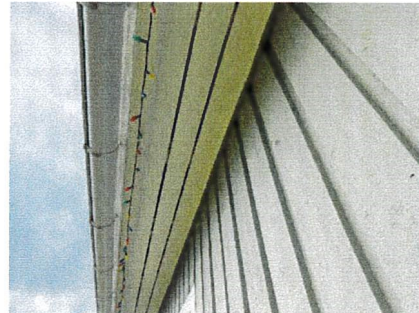
Ikke fluenett i takutstikk
