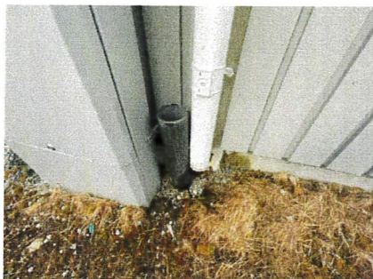
Nedløp ikke koblet til drens flere steder
