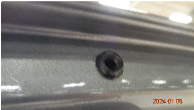
1.1 Rust i fals, rundt plugg bakluke innvendig .
