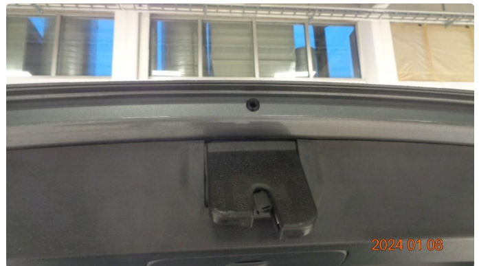
1.1 Rust i fals, rundt plugg bakluke innvendig .
