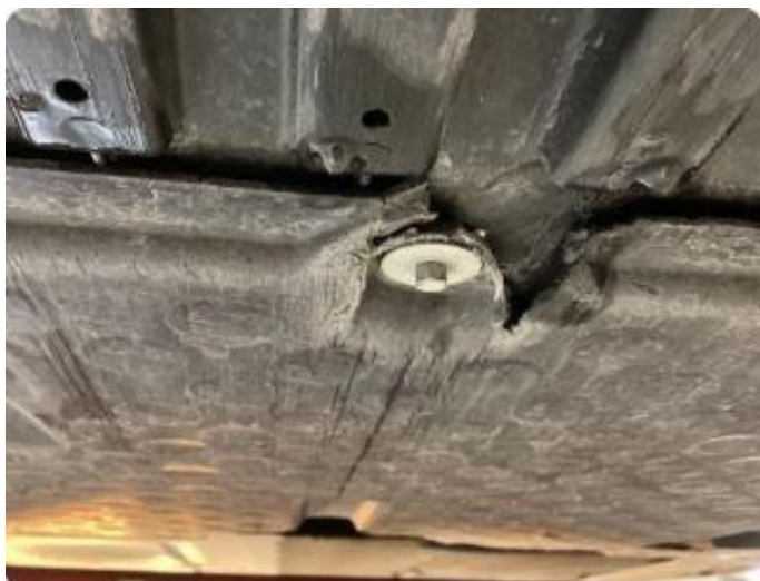
1.1 Deksel underbilen noe skadet.
