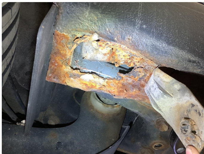
1.3 Mye rust i bærende konstruksjoner
