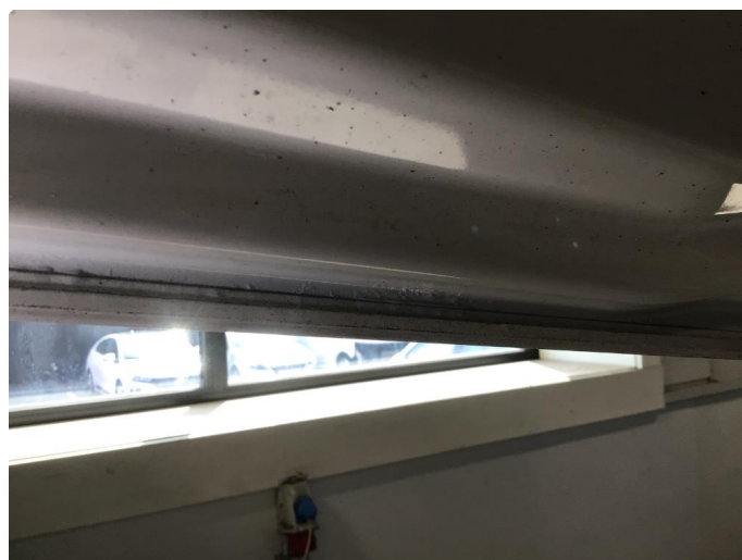
1.3 Rust i fals
