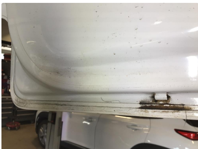
1.3 Rust i fals
