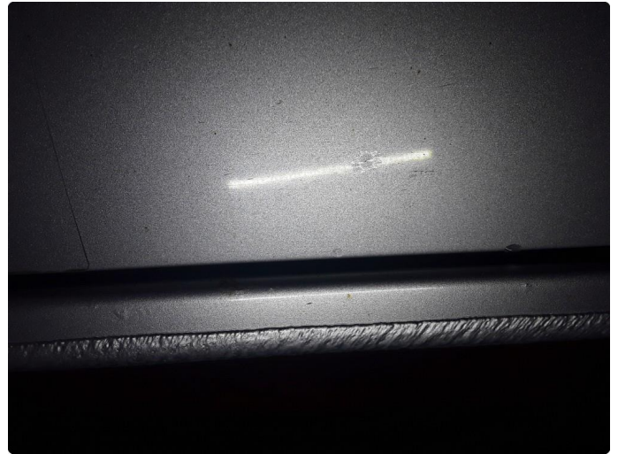
1.2 Steinsprut med korrosjon venstre skyvedør.
