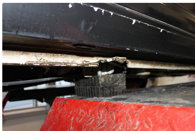
1.1 Skade i fals på kanal, samme plass begge sider bak.
