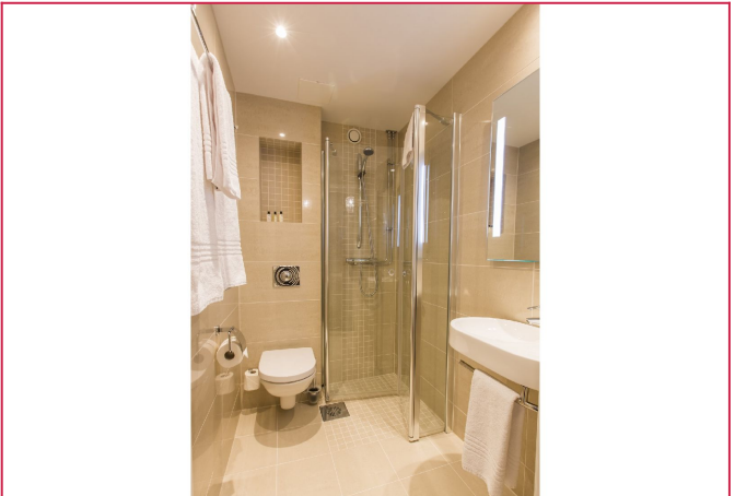
Bad med varmekabler
