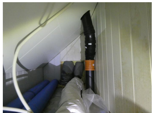
Lufting for avløp over tak.
