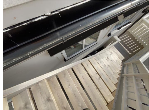
Åpning mellom trappeløp og garasjevegg.
