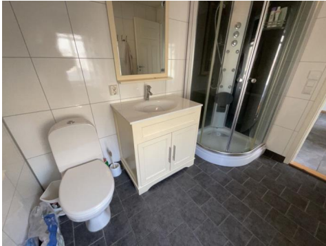
Gulvmontert klosett. Heldekkende se servant på servantskap. Dusjkabinett.
