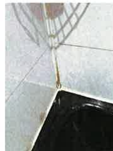
Bruk av treverk i hjørnet av dusjsonen er ikke i henhold til gjeldene normer og forskrifter
