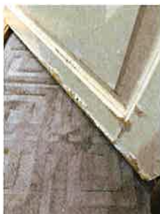
Det er fuktskader og slitasjer på innerdører
