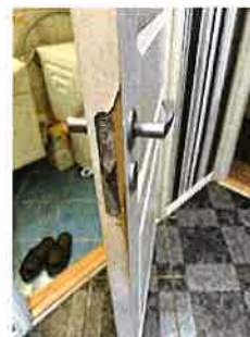
Det er fuktskader og slitasjer på innerdører
