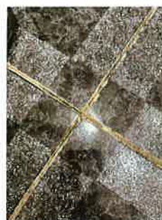
Sprekker og kalkutfellinger i flisfuger.
