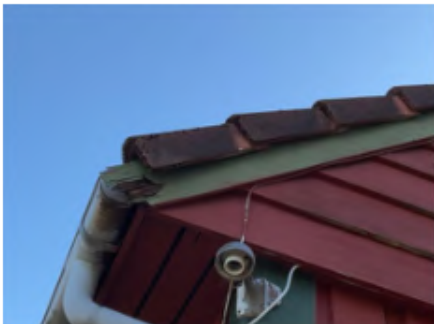
Råteskade i vindskier
