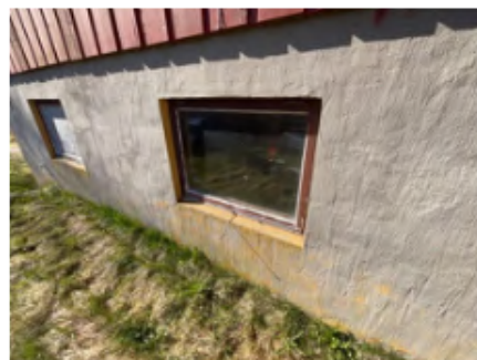
Vinduer har råteskader
