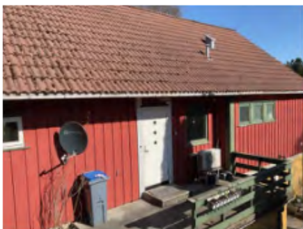
Det mangler snøfangere på tak over inngangsparti
