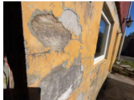
Løs puss på grunnmur
