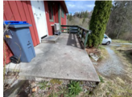
Her mangler det rekkverk.
