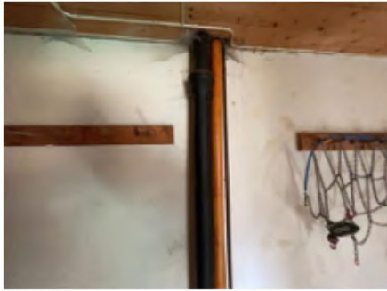
Avløp i eldre soilrør i støpejern.
