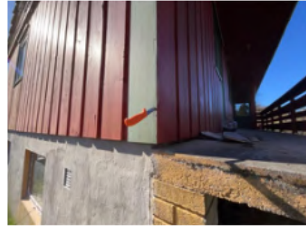
Stående kledning har spredte råteskader
