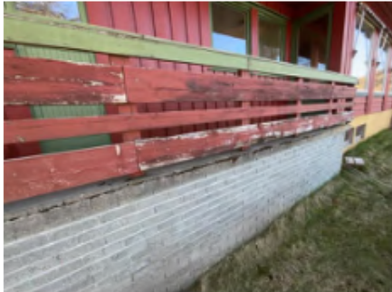
Rekkverket er i dårlig stand.
