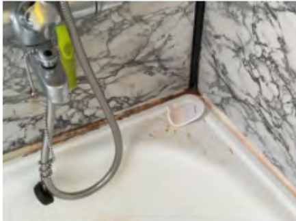
Baderomspanel har synlige fuktskader.
