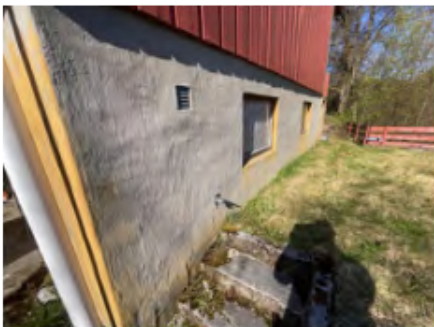
Sprekker i grunnmur
