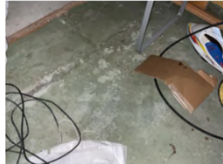
Saltutslag i kjellergulv
