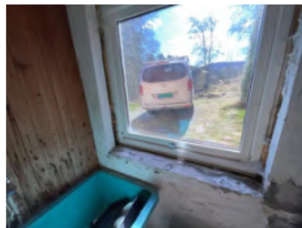
Kjellervindu er tregt å åpne og trenger justering
