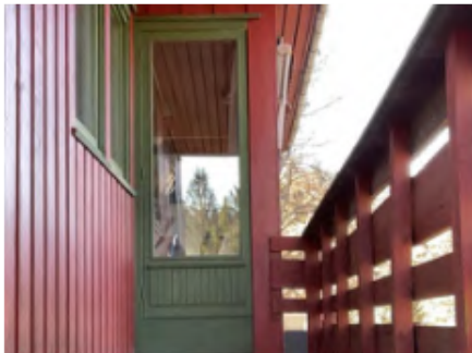
Terrassedør er i dårlig stand
