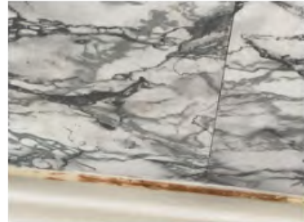
Baderomspanel har synlige fuktskader.
