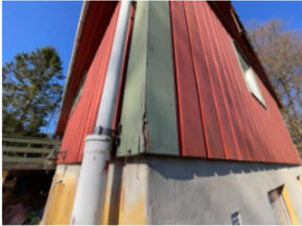
Stående kledning har spredte råteskader
