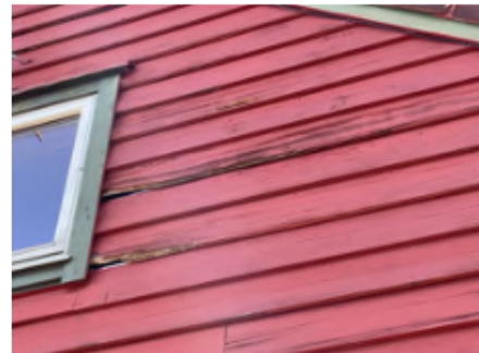
Bordkledning i gavl har en del råteskader
