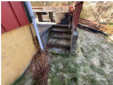
Utvendig trapp er værslitt.
