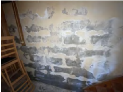
Saltutslag i kjellermur
