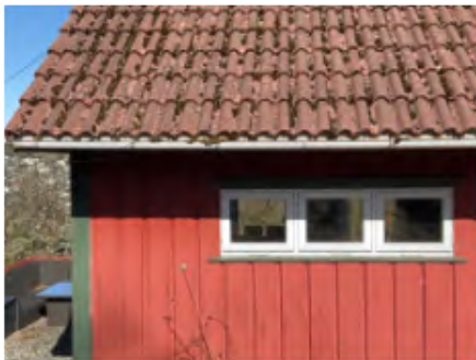
Takrenner er full i mose.
