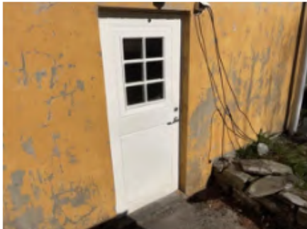
Kjellerdør har fuktskader
