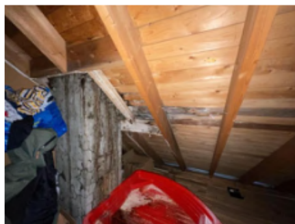
Det er lekkasje rundt pipen.
