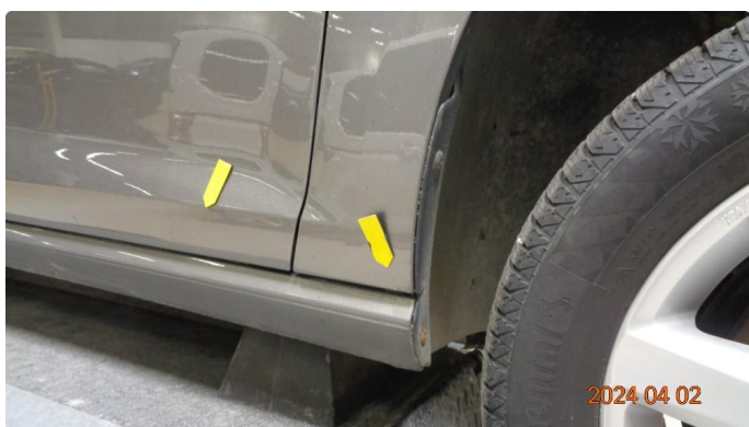
1.8 Rust høyre forskjerm
