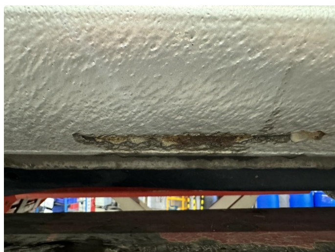
2.2 Tersklene har noe rust
