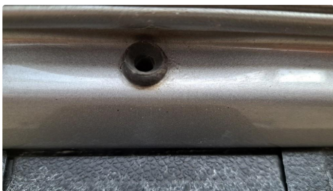
1.3 Påbegynt korrosjon innvendig ved drenering.
