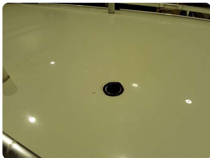
2.8 Steinsprut med rust Og hull
