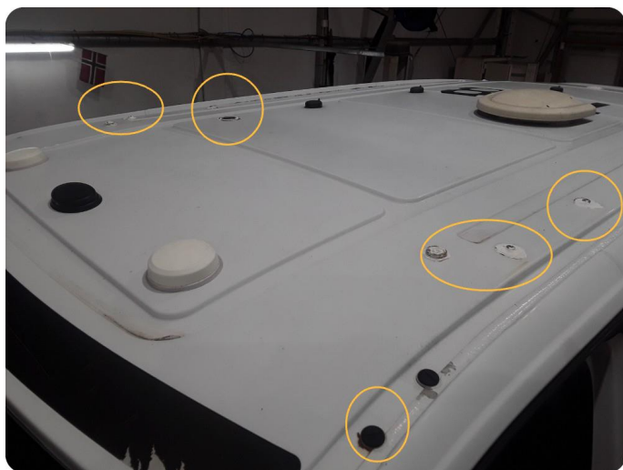
3.7 Ufagmessig utført arbeid -og noe rust
