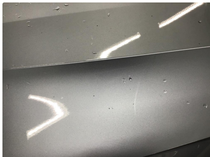
1.1 Steinsprut /Brukslitasje panser
