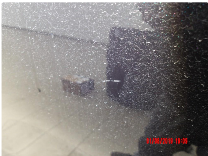
1.1 Generelt mye bruksslitasje
