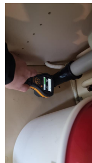
Fuktmåling i benkeskap - ingen høye verdier
