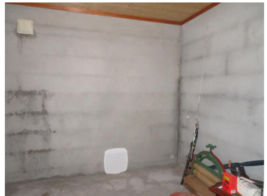
Del av innvendige overflater. Merk spesielt at murvegger viser dels noe fuktutslag.
