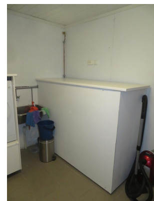
Begge beredere ses innkasset på vaskerom i sokkelplan.
