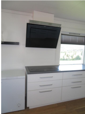
Avtrekksventilator over kokesone.
