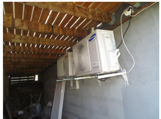
2 stk luft til luft varmepumper - ukjent installasjonsalder.
