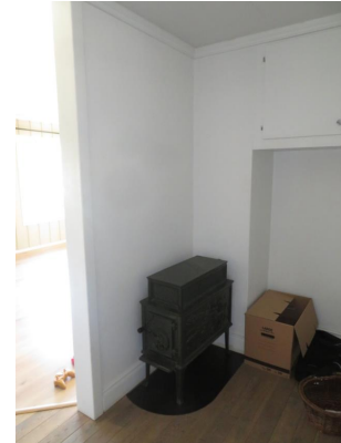
Vedovn i gang - merk at gulvlist er ført inn under ovn, noe som ikke samsvarer med anbefalinger om avstand til brennbart.
