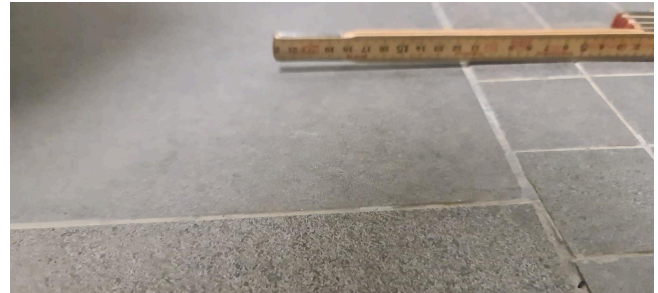
Bilde viser trapping i overgang stor flis;600x600 og flis 60x60
