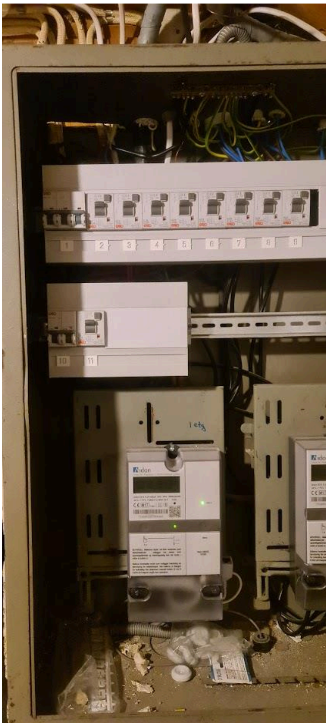
Sikringskap, hvor det er åpne hull i topp skap.
