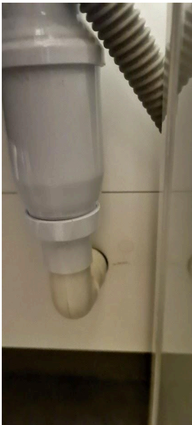
Bilde viser manglende elastisk fuge(det er utbedret) rundt avløp fra vaskemaskin gjennom baderomspanel.
