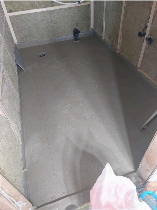
Bilde tatt av eier viser banemembran som er overmalt med godkjent smøremembran, hvor banemembran er montert under klemlist på sluk(opplyst av eier).
