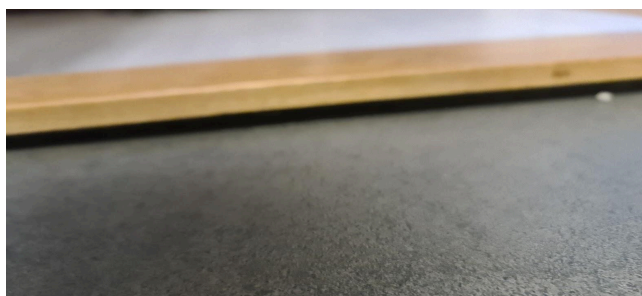
Bilde viser åpning under dørterskel, men eier opplyser at banemembran er montert opp til under kant dørterskel.
