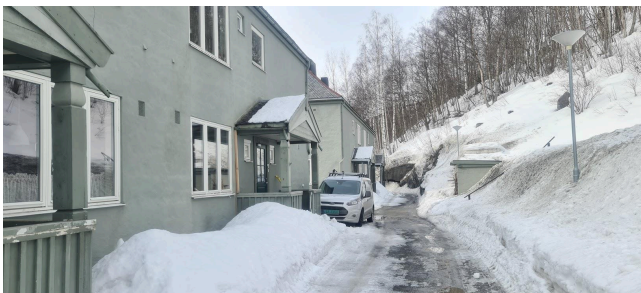
Bilde viser inngang hvor takrenne er skadet.
