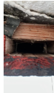
Manglende lusing bak kledningen
