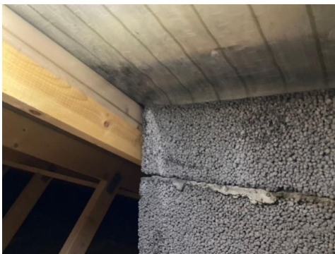
Utett gjennomføring i undertaket
