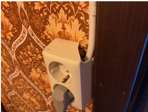
Eksempel på skader på el-installasjonen.
