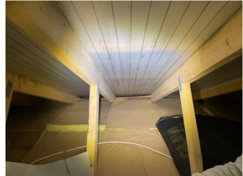
Dårlig ventilering ved takfoten.
