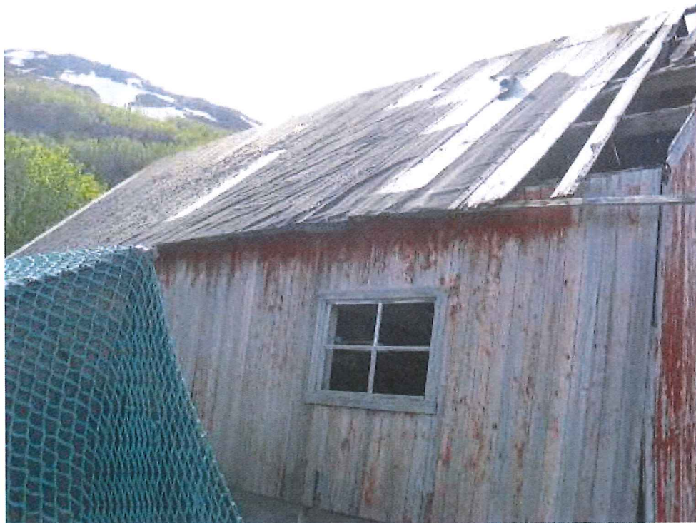
Naust skader tak/vegger
