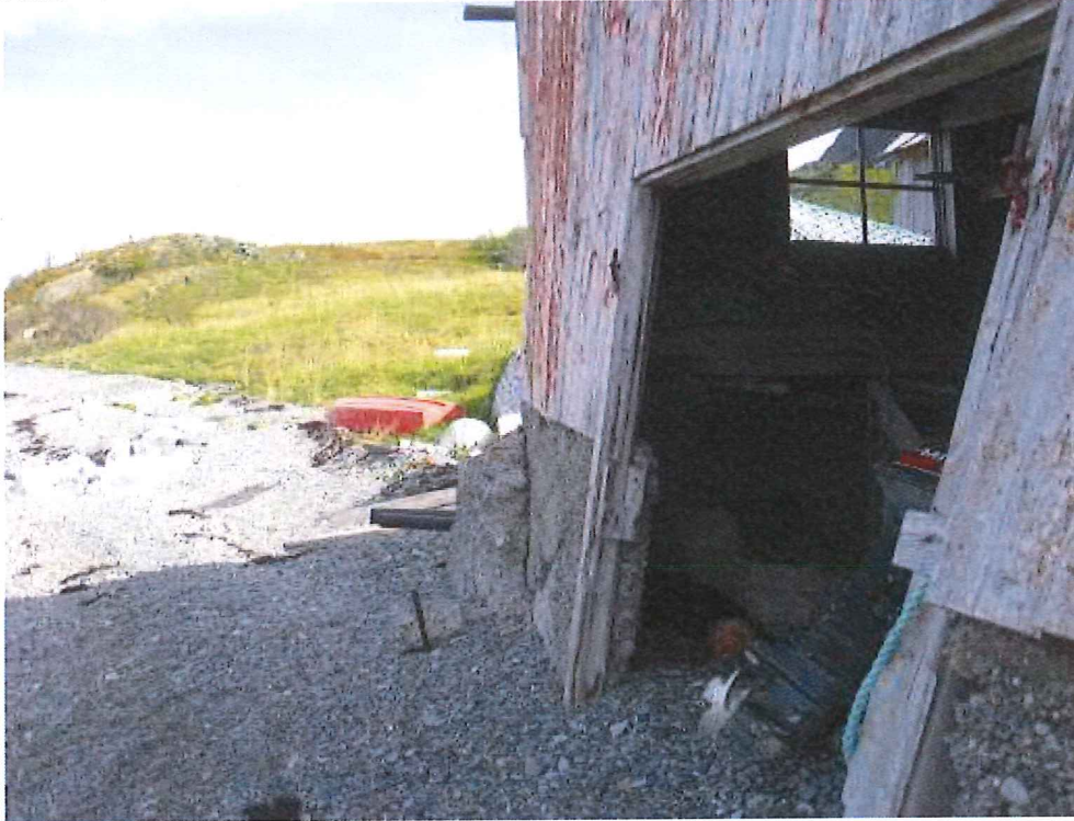
Naust med skader i front
