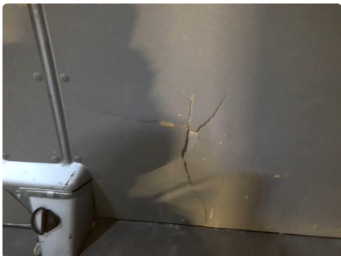
4.2 Deksler skadet. Utbedres ikke.
