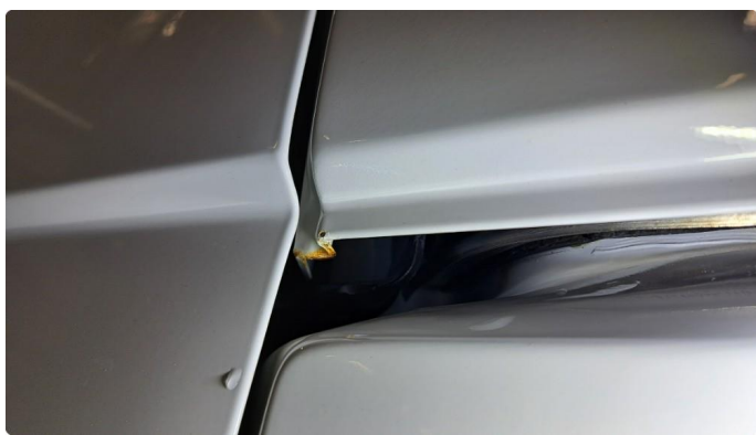
1.5 Rust i framkant av skinnedeksler.
