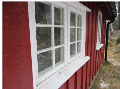
Doble vinduer. Bra vedlikehold.
