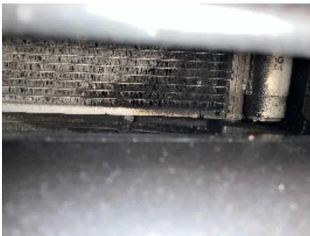
43. Varmeapparat / klimaanlegg (AC)
