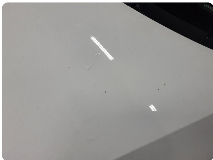
1.2 Noe steinsprut med rust
