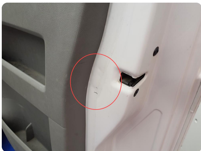
3.3 Øvrige feil Bulker, riper, rust
