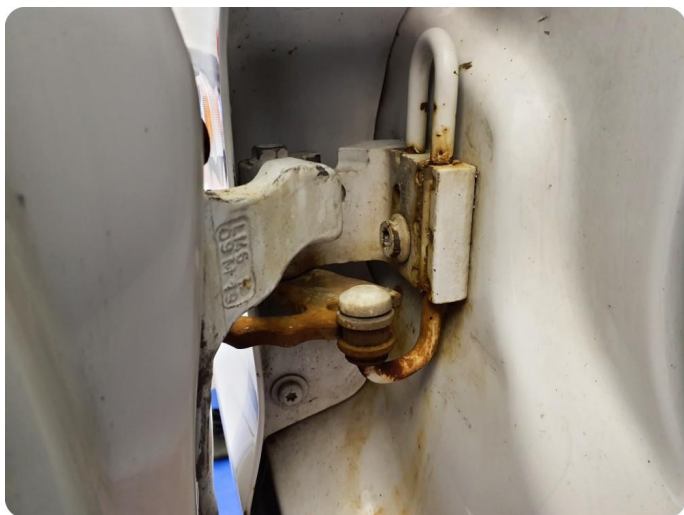
3.3 Øvrige feil Bulker, riper, rust
