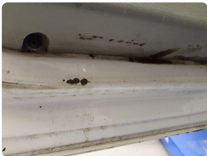
3.3 Øvrige feil Bulker, riper, rust
