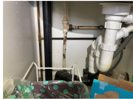
Oppvaskbenk kjøkken 1.etasje. Vannrør er ikke tilstrekkelig klamret.
