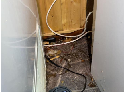
Trapperom/gang innsig av fukt fra grunn.
