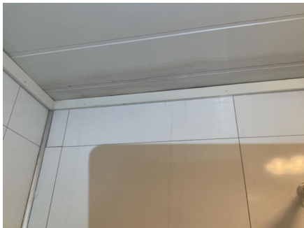
Fuktroser innvendig tak.
