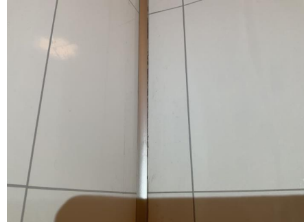
Glippe og utettheter mellom våtromsplate og hjørnelist.
