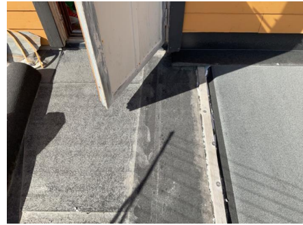
Papptekking ufagmessig utførelse og utett yttertak.
