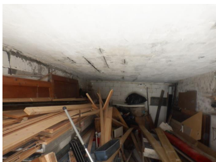
Brudd i plasstøpt betongdekke.
