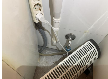
Avløp fra vaskemaskintrakt er ikke klamret.
