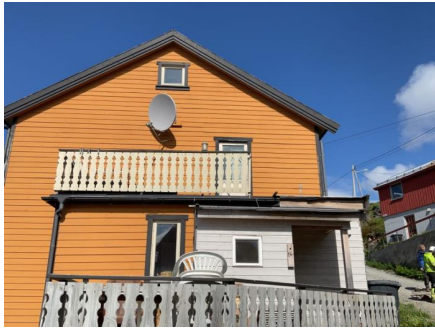
Rekkverk sikring mangler. I tillegg skade på eksisterende rekkverk.
