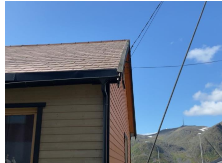
Vindski- og vannbord ute av posisjon.
