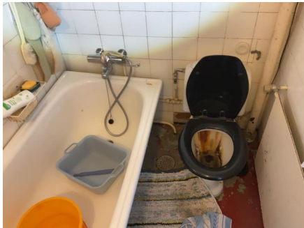
Bad elde montasje fra byggeår.
