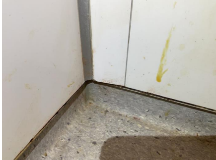
Skade og ufagmessig utførelse registreres.
