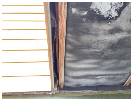
Åpen vindsperre som vil medføre til trekk inn i konstruksjon.
