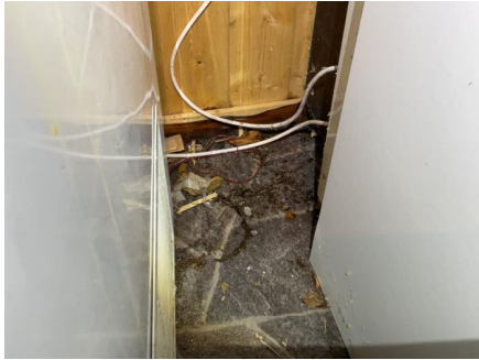
Østfasade innsig av grunnvann langs øvervegg.
