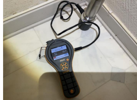
Kjøkken høye fuktverdier måles i tilfarergulv.
