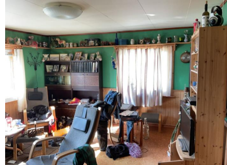
Innvendige overflater eldre modernitet og utsatt vedlikehold.
