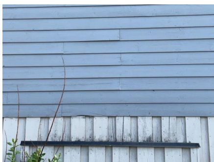
Vestfasade registreres svekkelse og spredte råteskader.
