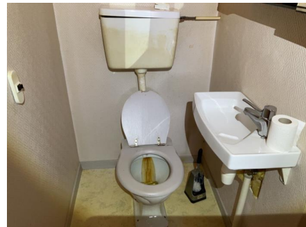
Lekkasje fra cisterne.
