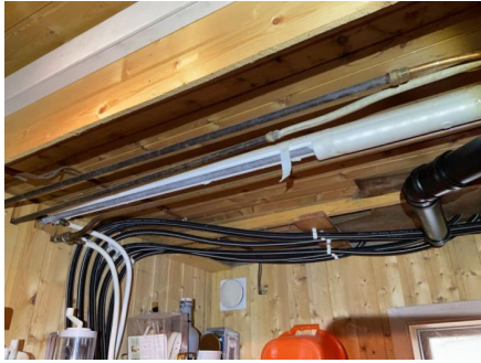
Trapperom underetasje. Trykkførende vannrør i kobber som ikke er tilstrekkelig klamret.
