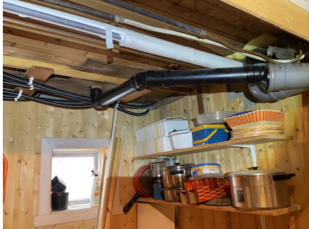
Trapperom underetasje. Avløpsrør er ikke tilstrekkelig klart.
