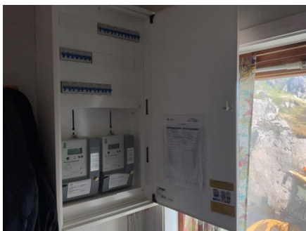
Sikringsskap med automatsikringer.
