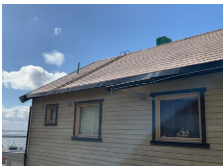
Østfasade skade på takrenne og nedløp.
