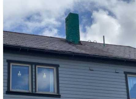
Skade på takteking ut mot takfot.
