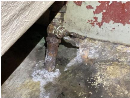
Lekkasje fra innvendig stoppekran.
