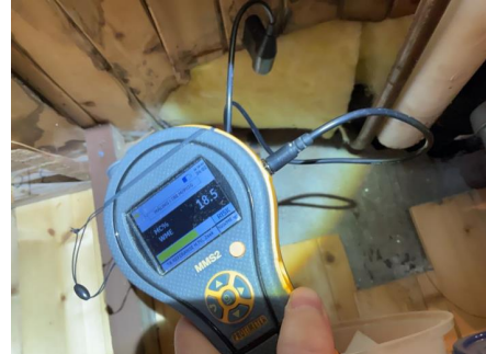
Økt fuktkvotente måles i innvendig tak inn under bad.
