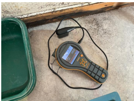
Tilbygg sørfasade avdekkes det fuktskader i konstruksjon.
