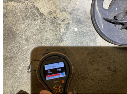
Måleindikator viser markerte utslag på fuktsøk mot betonggulv.
