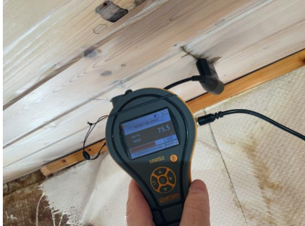
Bod med innvendige skader og høye fuktverdier måles.
