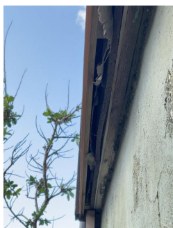
Manglende musesperre samt vindsperre er ikke klemt med klemløker.
