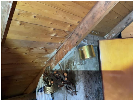
Fuktskjolder i taktro rundt gjennomføring i yttertak.
