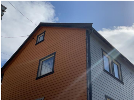
Redusert gjennomgående lufting av yttertakkonstruksjon.
