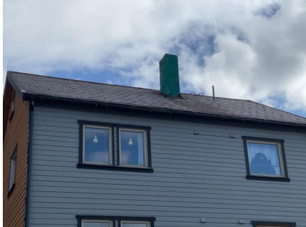
Taktekking med markant slitasaje.
