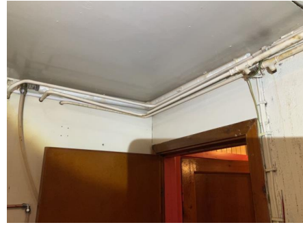
Vannrør i kjeller er ikke tilstrekkelig klamret.
