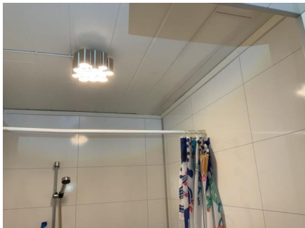
Bad registreres det fuktskader i konstruksjon.
