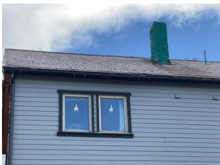
Heng på takrenne og skade på rennekroker.
