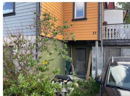
Taknedløp sørfasade uten utkast og bortledning av vann fra grunnmur.
