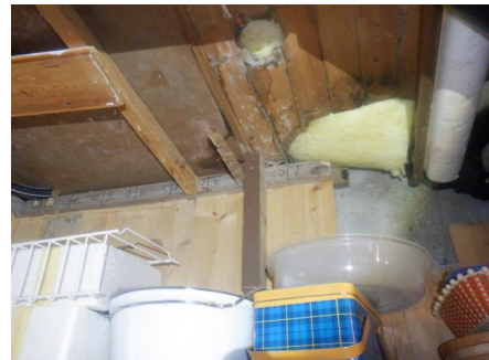
Inn under overliggende våtrom avdekkes det fuktutslag i innvendig tak.
