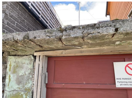
Brudd i plasstøpt betongdekke.
