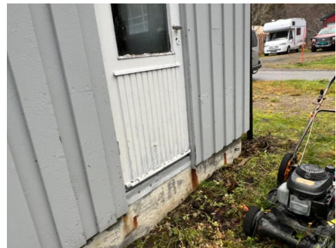
Stedvis råte og slitasje på dører
