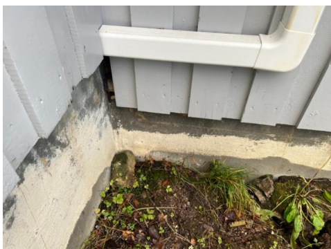
Ikke synlig fuksikring
