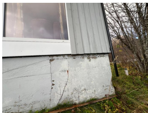
Sprekker og avskalling på mur
