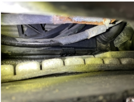
43. Utvendig tilstand motor
