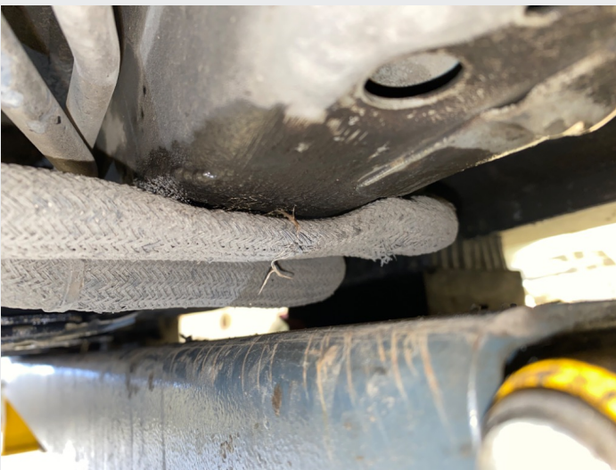
5.8 Kjølerør klemte høyre sode ved batteri
