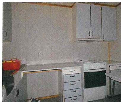
Bildet viser deler av kjøkken med mekanisk avtrekk over k
