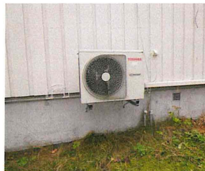
Bildet viser installert varmpumpe.
