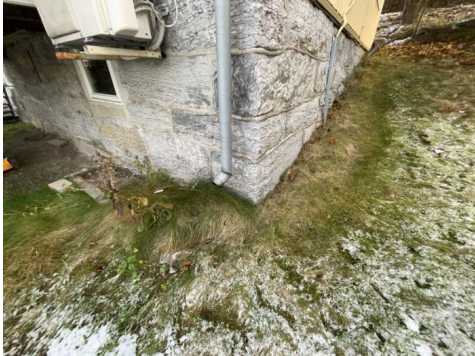
Det er ikke tilfredsstillende bortledning av vann fra taknedløp ved grunnmur.
