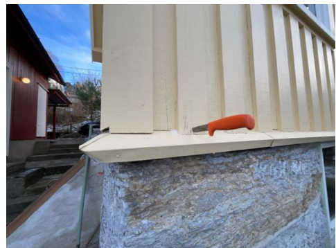
Det er påvist spredte råteskader i bordkledningen.
