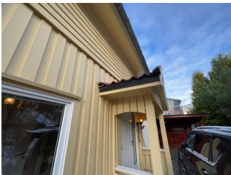
Mangler takenne og beslag
