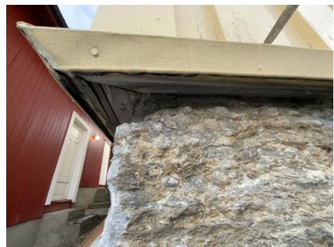
Det er ingen eller liten lufting i nedre kant av kledning mot grunnmur. Vil bla kunne medføre sen opptørking av konstruksjon
