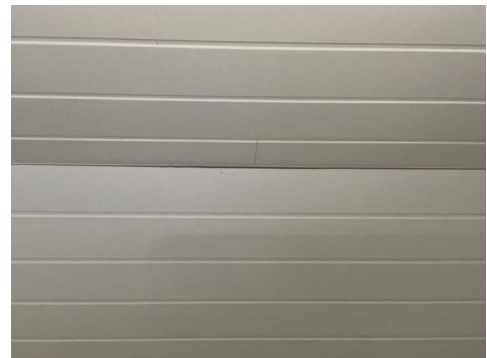
Yttertaket/ panel har stedvis nedbøying.
