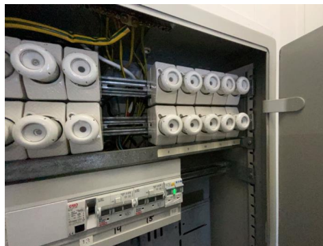
Flere oppførte kurser som ikke er i bruk. Behov for opprydding.
