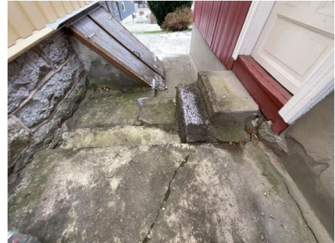
Betongtrapp har sprekker/skader
