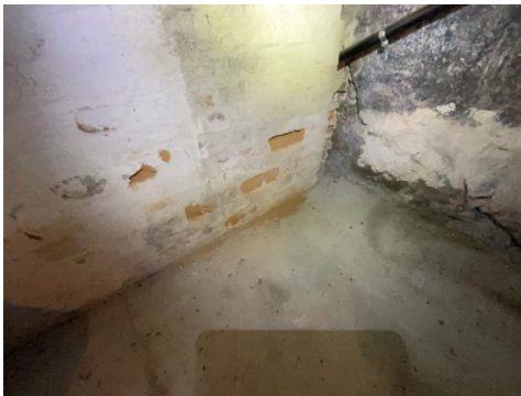
Skader i tegl pga fuktoppsug fra grunn
