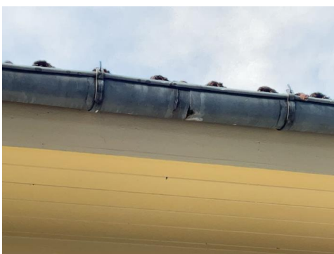
Takrenner har punktvis lekkasjer.
