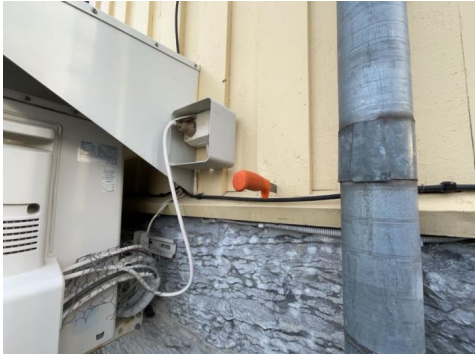
Det er påvist spredte råteskader i bordkledningen.
