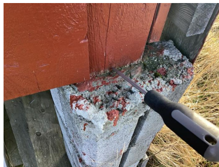
Råte nederst i kledning enkelte steder.
