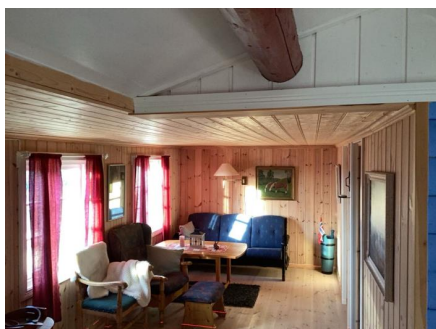
Det er ikke fremlagt dokumentasjon på endring av takkonstruksjon med tanke på bæreevne.
