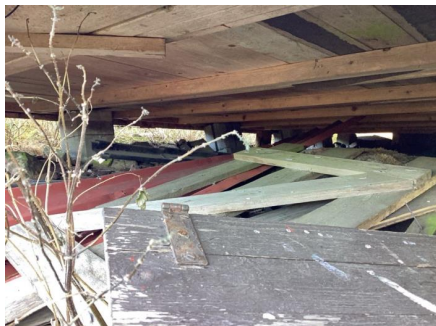
Skjevheter i flere pilarer.
