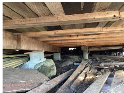
Skjevheter i flere pilarer.
