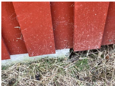
Råte nederst i kledning enkelte steder.
