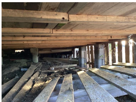
Skjevheter i flere pilarer.
