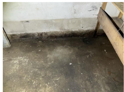
Fukt på gulv og vegg.
