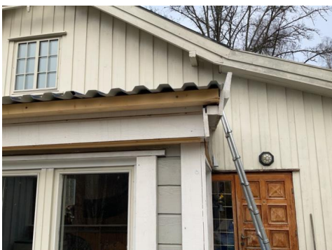
Det er ikke montert dekkbord på tilbygg i stue(kjøkken).
