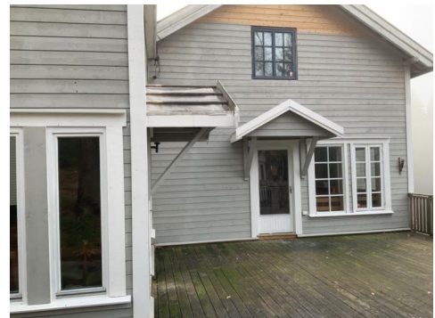
Det mangler taktekke på begge takoverbyggene.
