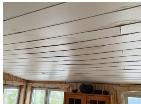
Tak i stue er fuktskadd.
