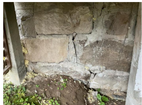
Sprekker i betongfuger på grunnmur.
