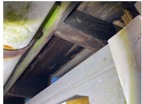
Fukt/kondensmerker på undertak på bad.
