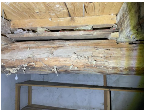
Tørråte i bjelker i kjeller.
