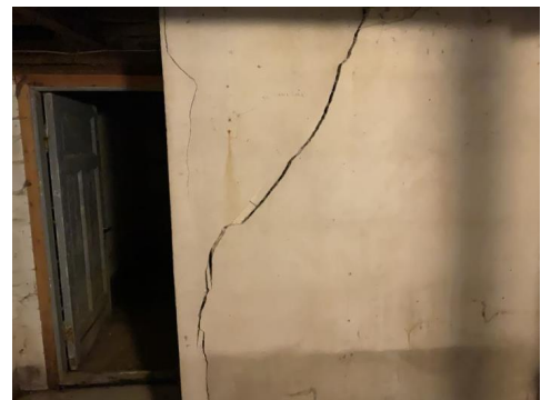
Sprekk i fundament til pipe.
