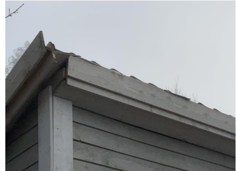
Det mangler beslag på tak over stue mot nord-vest.
