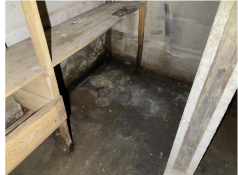
Fukt på kjellergulv/vegg.
