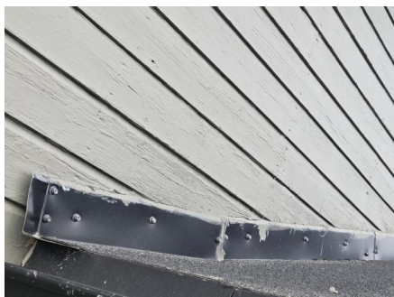
Tørkesprekker i bordkledningen.
