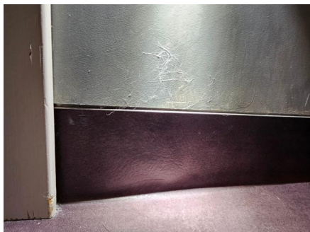
Ingen fuge mellom veggplate og sokkelprofil.
