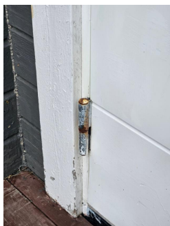
Rustskader i metalleder på hoveddør.
