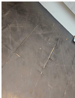
Slitasje i gulvoverflaten i 1. etasje.
