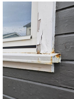
Rust, værslitasje og omramming lagt ned på vannbrett.
