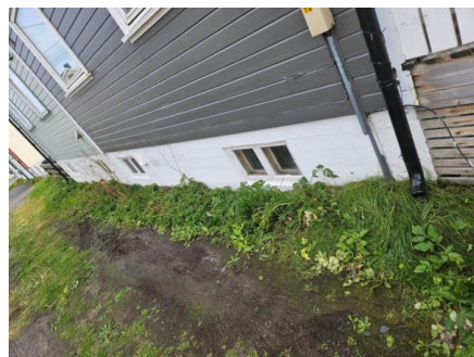
Terrengoverflaten har lite/ingen fall ut fra grunnmur mot sørvest.
