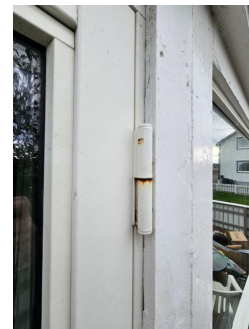
Rustskader i metalleder på balkongdør.
