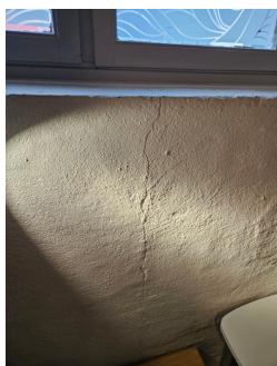
Vertikal sprek/riss under vindu i vaskerom.
