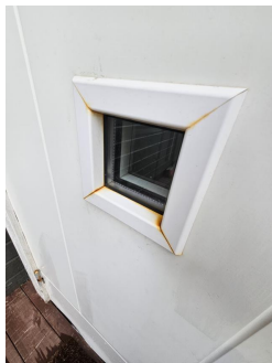
Rustskader i metalleder på hoveddør, samt svelling/fuktskader i nedre del av dørbladet.
