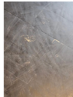
Slitasje i gulvoverflaten i 1. etasje.
