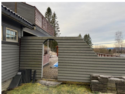
Levegg med skjevheter
