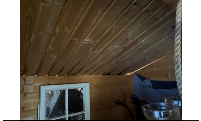
Fuktmerker i himling på bassenghus
