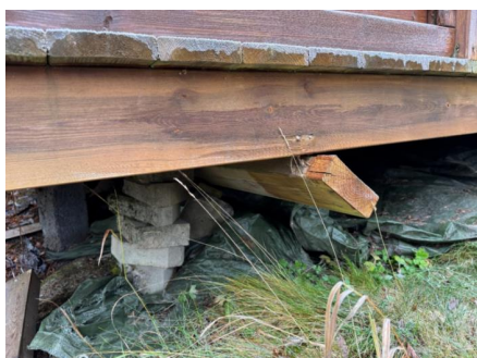
Skjev bjelke under terrasse
