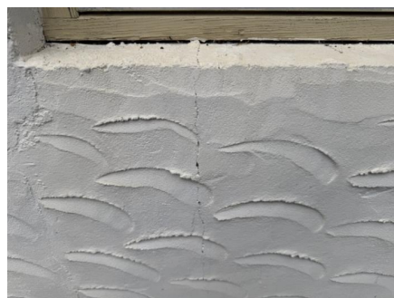
Sprekk/riss i grunnmur
