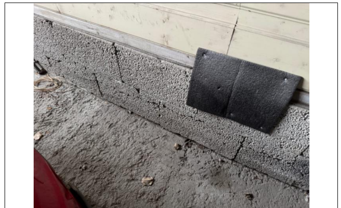
Setningsprekk i grunnmur
