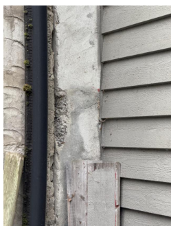
Avskalling utvendig på grunnmur
