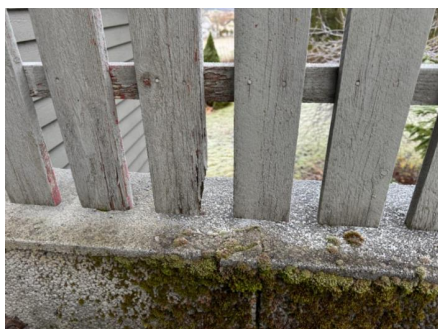
Rekkverk over støttemur med råteskader
