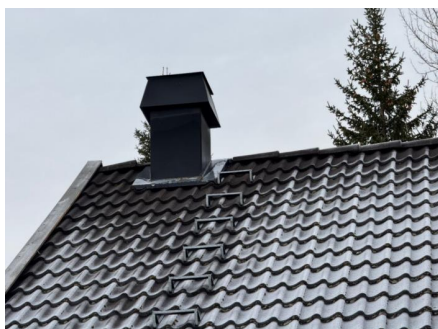
Avflassing og rust på beslag rundt pipe
