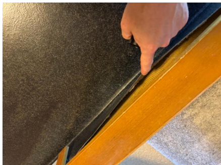
Løst belegg ved terskel
