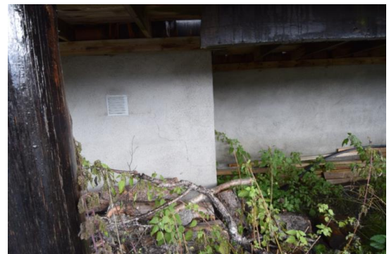
Sprekk i mur
