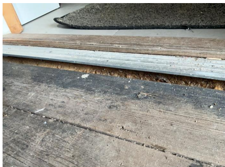
Manglende beslag under dør.
