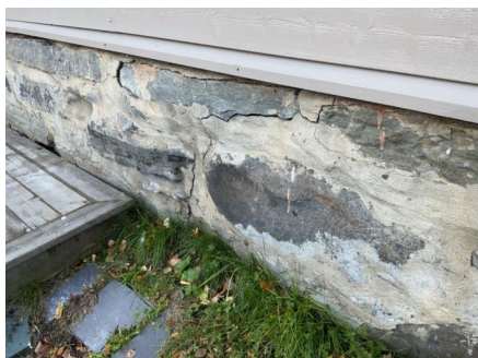
Sprekkdannelser enkelte steder.
