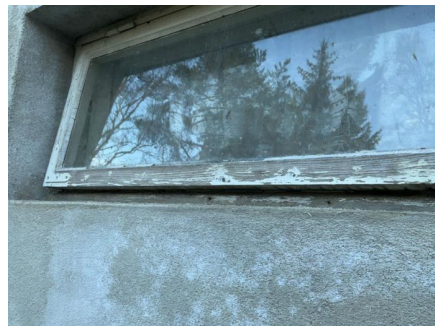
Kjellervinduer bærer preg av slitasje.
