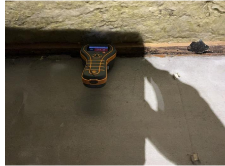
Enkle fuktmålinger i etasjeskiller mellom kjeller og 1. etasje viste skadelige verdier.
