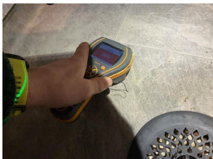
Enkle fuktsøk siden av sluk viste forhøyde verdier.
