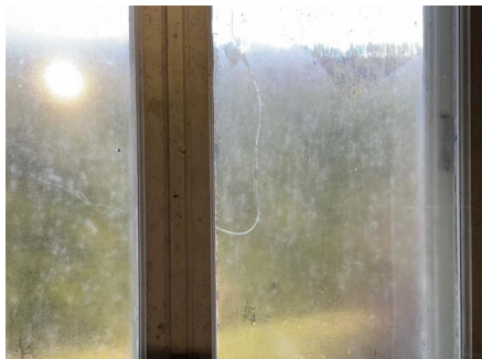
Enkelte sprukne kjellervinduer.
