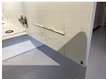
Enkelte skader og merker på innredning.
