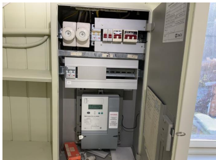
Sikringskap i loftsetasje. Manglende avdekninger.
