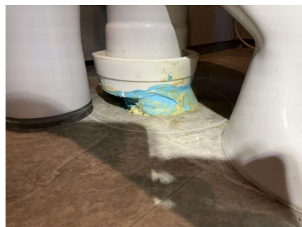
Utett/ufagmessig rørgjennomføring i gulv.
