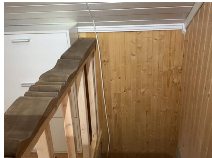
Løs ledning registrert.
