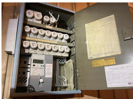
Sikringskap plassert i gang 1. etasje. Manglende avdekninger og utette gjennomføringer.
