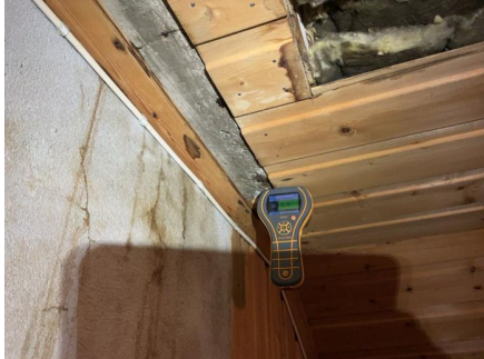
Fuktmerker flere steder, enkelte fuktmålinger viste tørre verdier.
