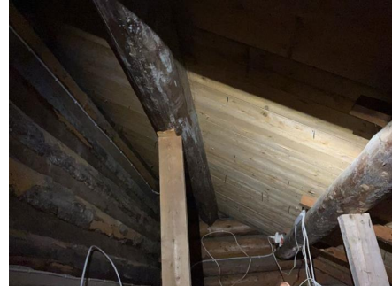
Synlige soppdannelser/misfarging i kott.
