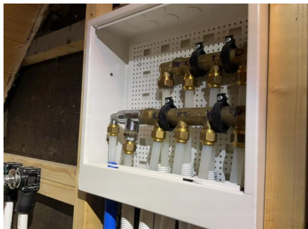
Fordelerskap under trapp. Manglende drenering til sluk.
