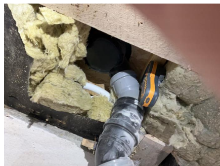
Fuktmåling i etasjeskiller under bad viste tørre verdier.
