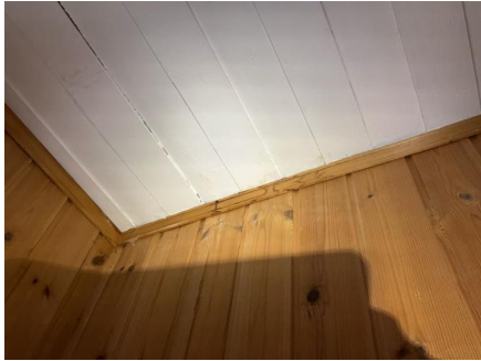
Synlige fuktmerker på himling i soverom 1. etasje.
