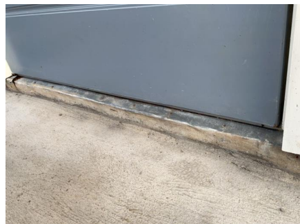
Svelling på dør, utett beslag under dør.
