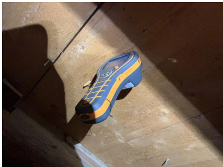
Enkel fuktmåling i undertak viste skadelige verdier.
