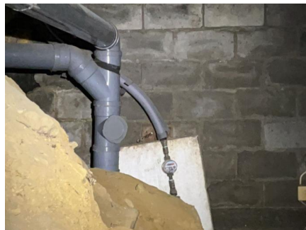
Stoppekran i krypkjeller.
