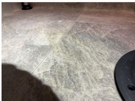
Løst gulvbelegg siden av sluk.
