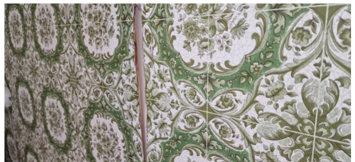
Eksempel på løs skjøt i tapet.
