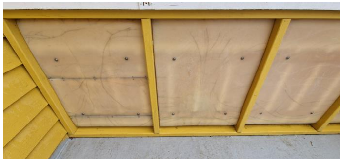
Riss/sprekker i vind-skjermende plastplater.
