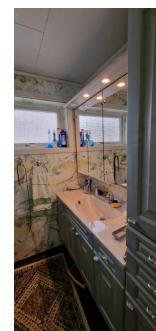
Overblikk av innredning. 2 stk. spotter av 4 over speil virker ikke. Det er antatt at det er pæren som er ødelagt og ikke selve spottene.
