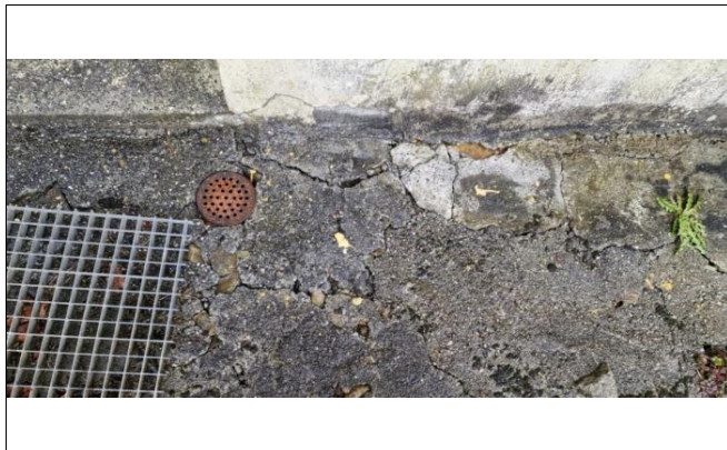
En del sprekker og skader på utvendig betongdekke/betongsti ved kjeller inngang.
