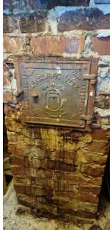
Eldre teglsteinspipe med rennemerker og rusten sotluke, sett fra kaldloftet.
