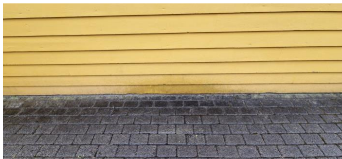
Området med råtedannelse ligger under takrenne som lekker ved skjøt.
