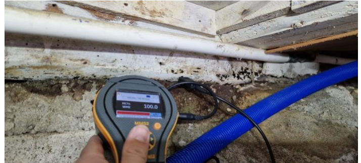
Trebjelke er metta av vann (100%), dersom bjelken blir stående under slike forhold vil den råtne på sikt. Sett fra kjeller i nærhet til bereder og avløpsrør under bad i 1.etg. Det er antatt at fukten er relatert til drenering, basert på at våtrommet over ikke har vært i bruk de siste 3-4 mnd. iht. omvisere.
