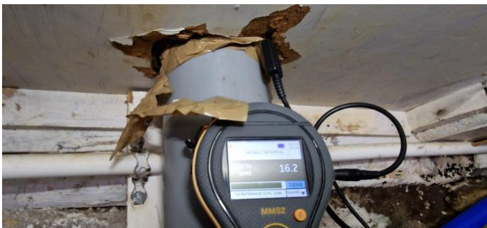
16.2% - antatt ok basert på at kjelleren generelt har ett fuktig inneklime.
