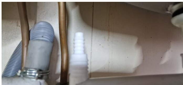
Kobling er ikke tett pr.dd., det åpningen bør tettes.
