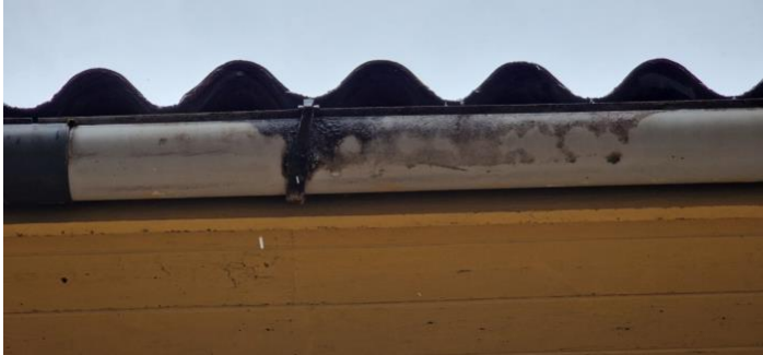
Observert lekkasje punkt i takrenne.
