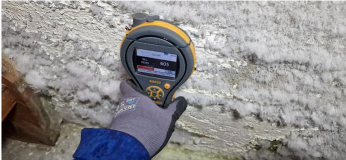
Generelt mye saltutslag på yttervegg under terreng, høy fuktindikasjon.
