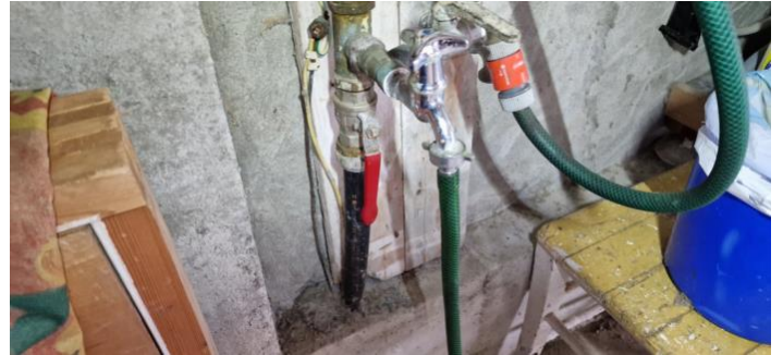
Vannutkaster og koblinger i vaskjekjelleren.
