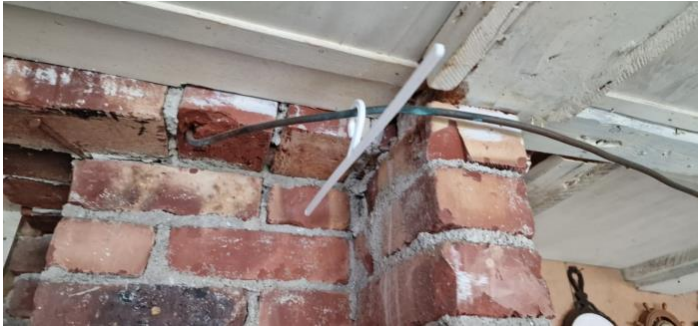
Eldre kobberør, antatt ifbm. olje-/diesel-tank, som er fjernet pr.dd.
