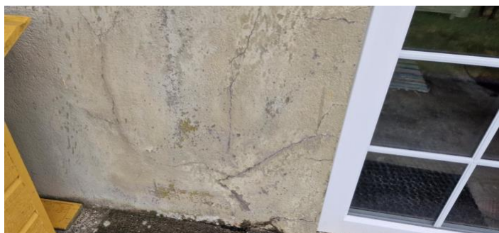
Små riss og sprekker i utvendig puss.
