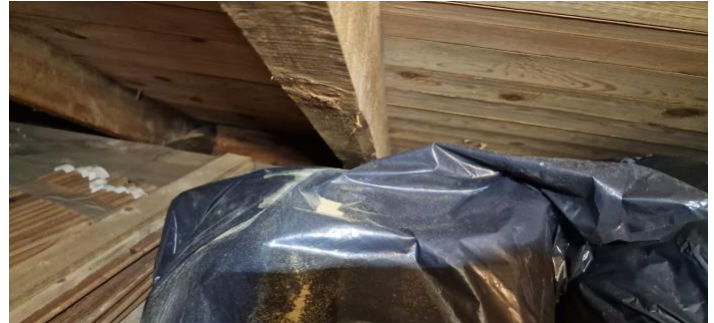
Uisoleret mellom taksperr, synlig mottpulver over lagrede gjenstander.
