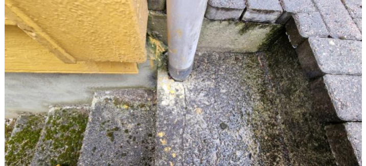
Nedløp leder til grunn/terreng, men ikke videre vekk via overløp o.l. iht. omviser. Nedløpet er i nærhet til trebjelke med påvist høy/metta fuktighet i kjelleren.
