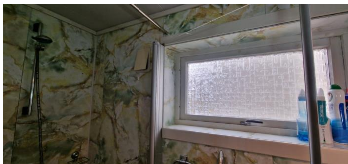
Vinduet er av tre og er plassert i nærhet til dusjzonen, pga. glassdør virker sannsynligvis avvirket pr. nå. Men ved bruksendring vil det kunne være behov for tiltak på vinduet pga. vannpåkjenning fra dusjsone/våtsone.
