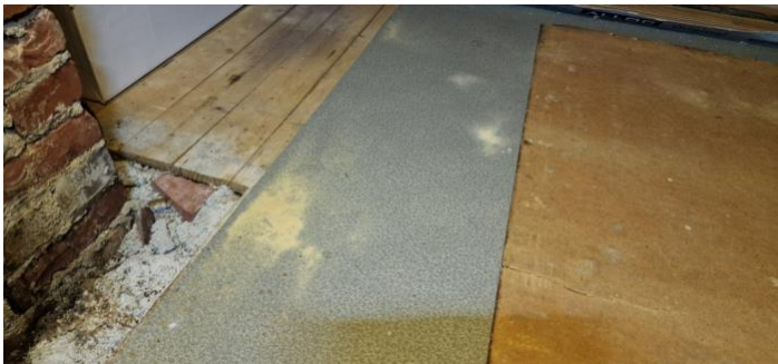
Mottpulver flere steder på kaldloftet.
