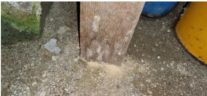
Mottpulver enkelte steder ved kjelleren.
