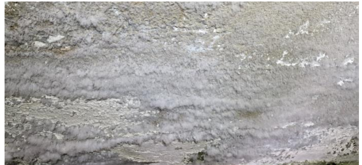
Mye saltutslag i kjelleren.
