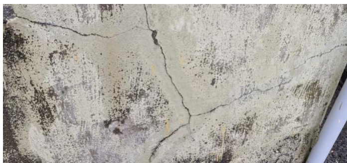
Små riss og sprekker i utvendig puss.
