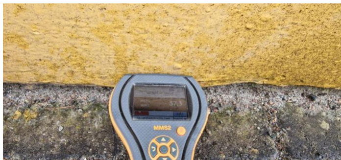
37% - Ikke ok. Nedre kledingsbord ved inngangspartiet er svekket og har tegn på råtedannelse og fuktighet inni treverket. Påregnet tiltak og utskifting.
