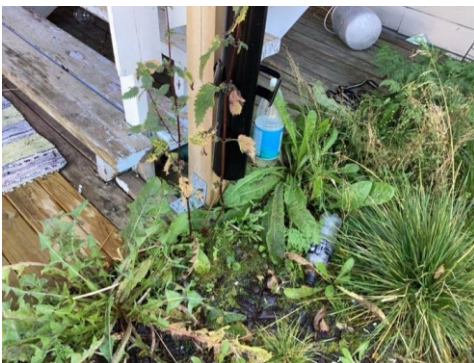
Eksempel på ikke tilfredsstillende bortledning av vann fra taknedløp
