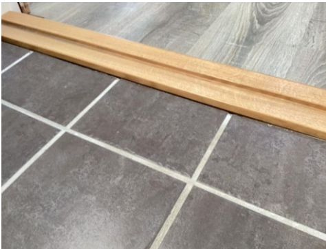
Dørterskel uten luftespalte
