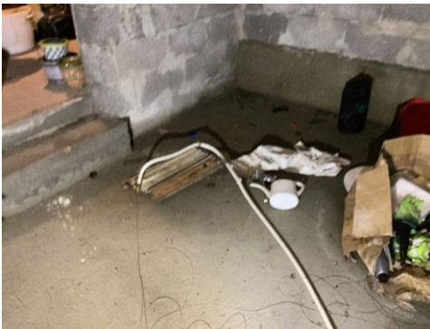
Eksempler på fuktgjennomtrengning
