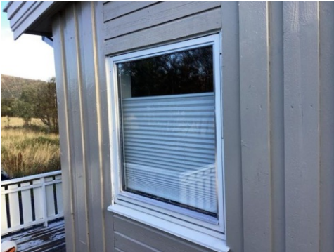
Eksempel på manglende beslag
