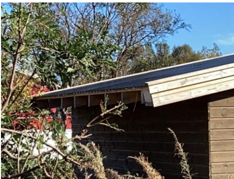
Takrenner og -nedløp mangler.
