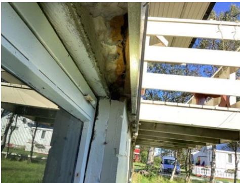
Skumtetting/ manglende lufting
