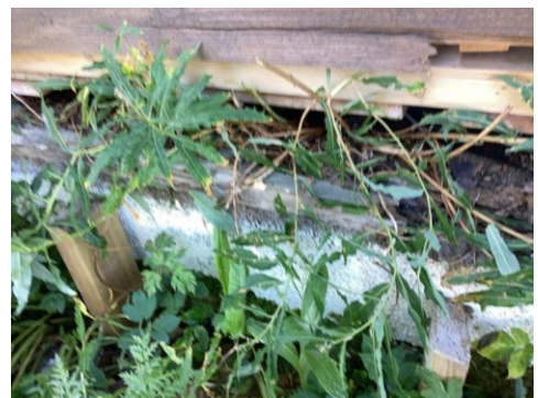
Eksempel på råteskade
