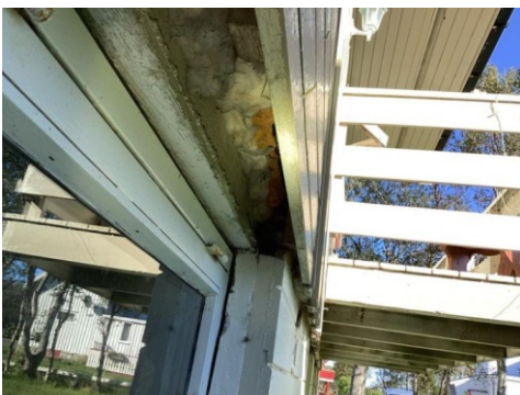
Skumtetting/ manglende lufting
