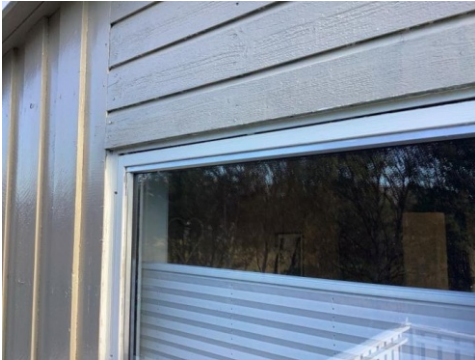
Eksempel på manglende beslag
