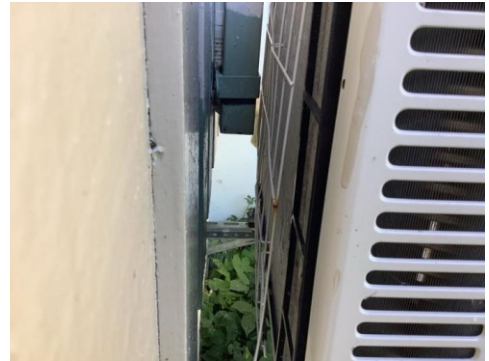
Eksempel på ikke tilfredsstillende bortledning av vann fra taknedløp
