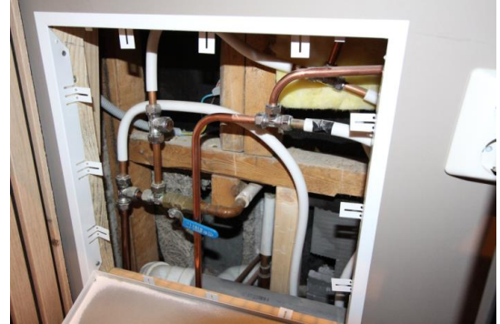
Stoppekran og vannledninger.
