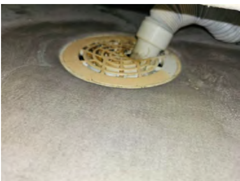
Vanskelig tilgjengelig sluk
