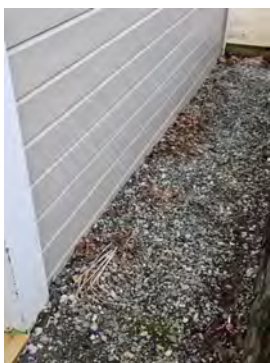
Grus over nedre kant av bordkledning
