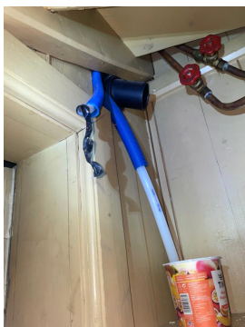
Manglende avslutning av vannrør
