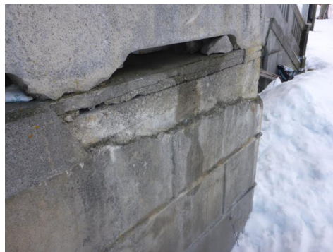
Eksempel på løsnet puss.
