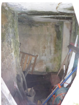
Synlig vanninntrenging i rom under terrasse.
