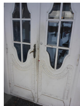
Værslitt/manglende vedlikehold Hovedytterdør.
