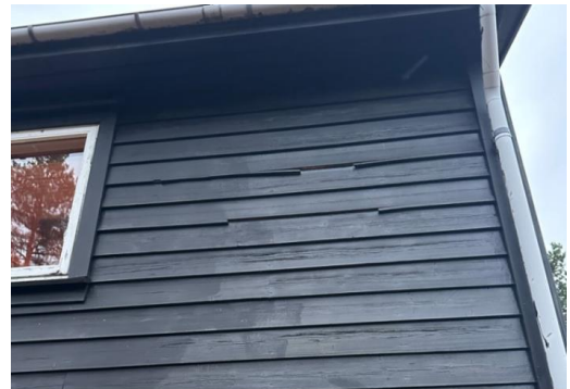
Råteskade i kledning.
